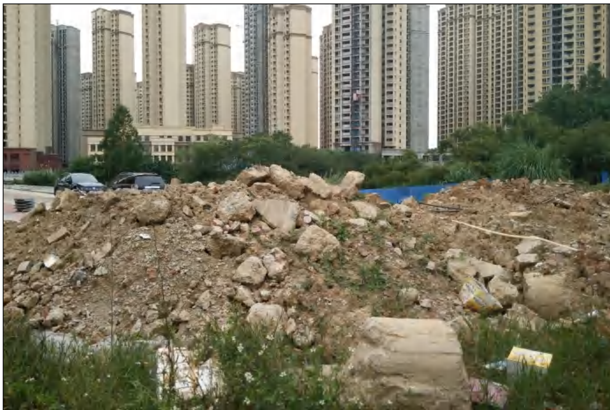
项目用地东地块北面临时堆土现状，建议临时覆盖密目网，减少水土流失
